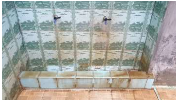
Gambar 9. Kondisi tempat wudhu setelah aksi
